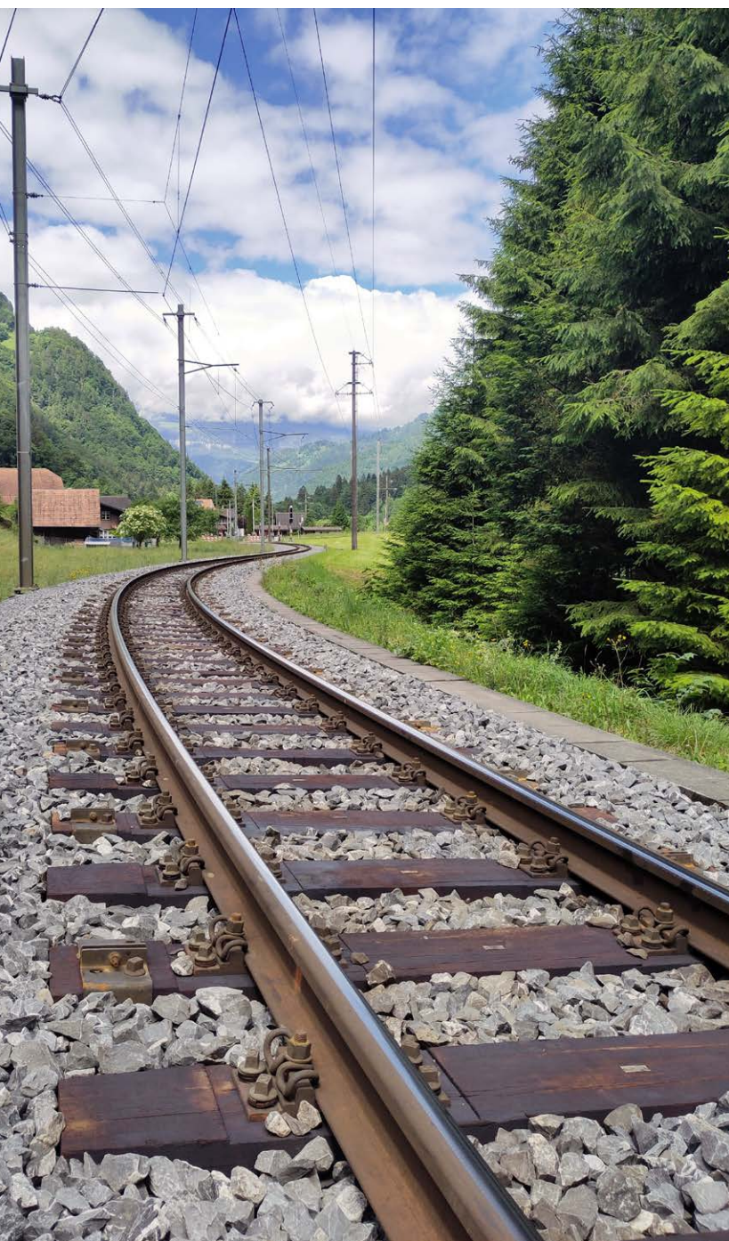
traverses de voie avec bêche de sécurité, Zweilütschinen et Lauterbrunnen
